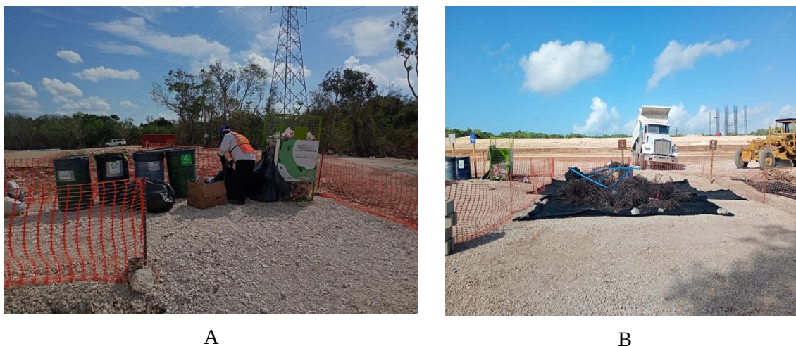
Figura 5. (A) Contenedores para almacenamiento temporal de RSU. (B) Área destinada a residuos metálicos.
